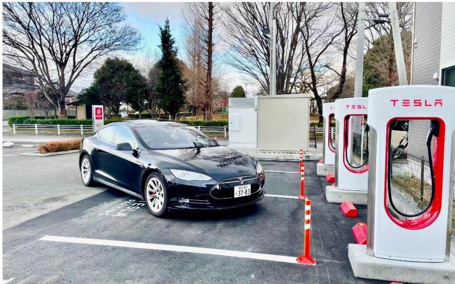
《フルーツピークス 郡山コスモス通り店お客様駐車場内に設置された『スーパーチャージャー』》
